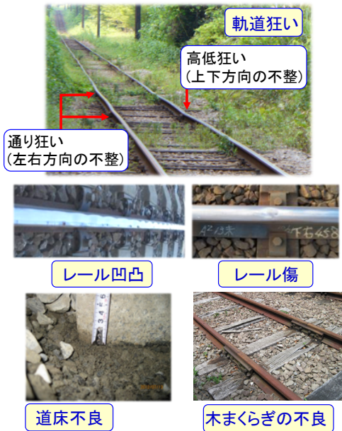
図 1.1 軌道の劣化の例
